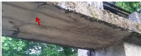
Exemple de désordre de l'ouvrage : fissure transversale
