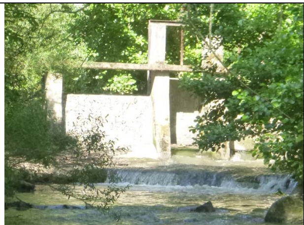
Présence d'une chute à l'aval (~ 0,35 cm) des vannes
